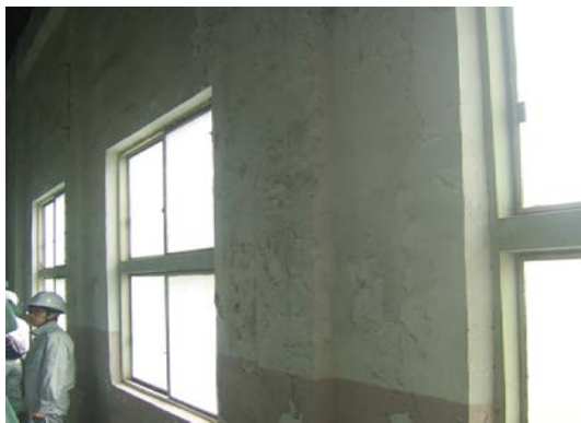
国内最古級の鉄筋コンクリート造建築物 (壁のクラックに歴史を感じます)
