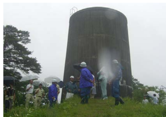
山の上に設置されているサージタンクへ (山道を登って40分:さすがに疲れた)
